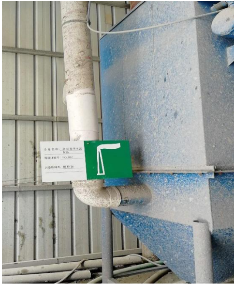
制砖生产线废气排放口标志牌
