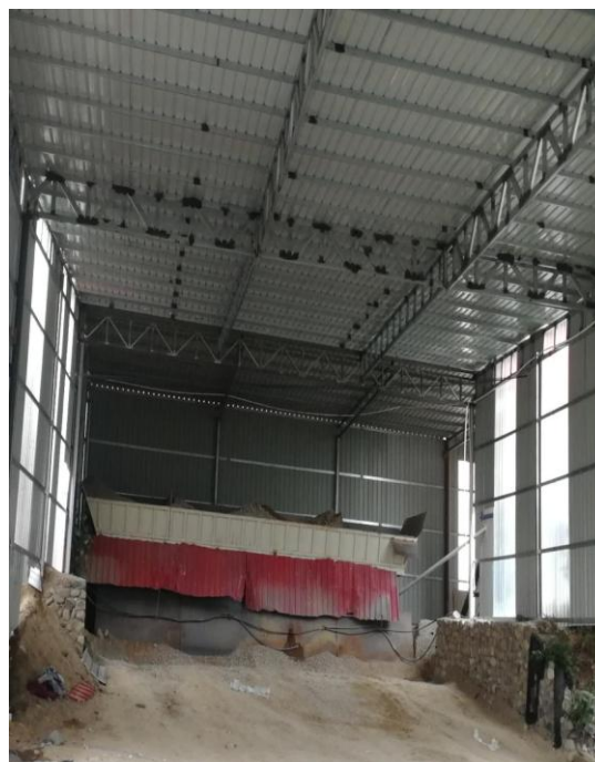
混凝土料仓喷淋装置
